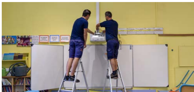
Les travaux d'entretien des écoles effectués pendant les vacances sont assurés par les agents des services techniques.
