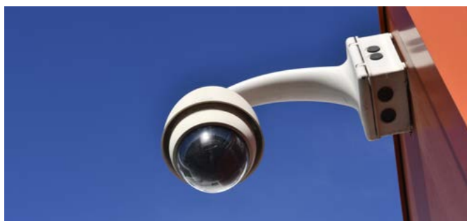
Le réseau de vidéo protection entre dans les compétences du service Voirie qui assure les études, estimation des travaux, programmation, suivi budgétaire et réponses aux usagers.
