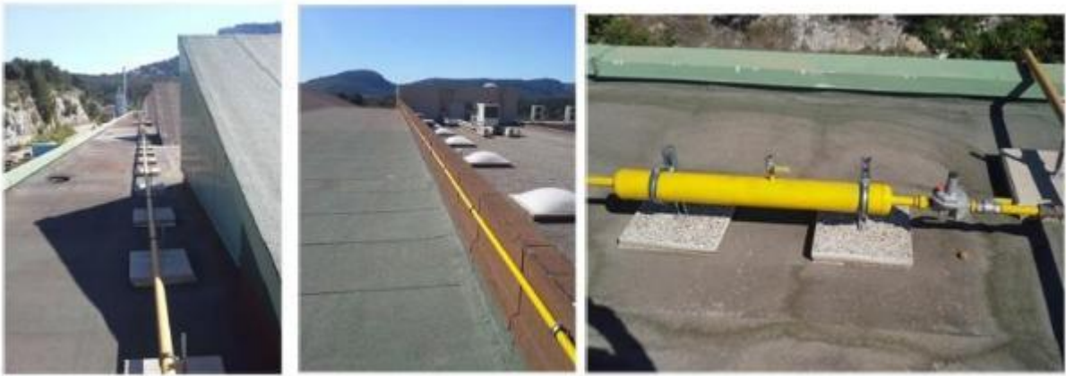
Figure 7 : Vue du réseau de gaz sur le toit du bâtiment
