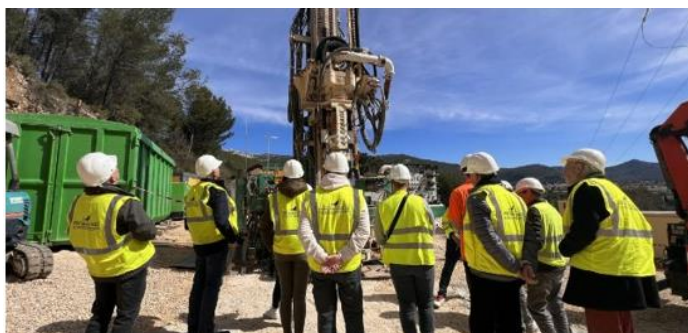
Visite chantier forage Puyricard sur Cuges-Les-Pins avec les élus de la municipalité
